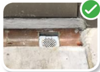
Use metal gully trap Gunakan penutup longkang besi
